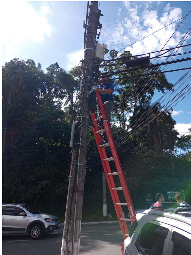
Figura 1: Instalação de Câmeras de Monitoramento em locais críticos do município
